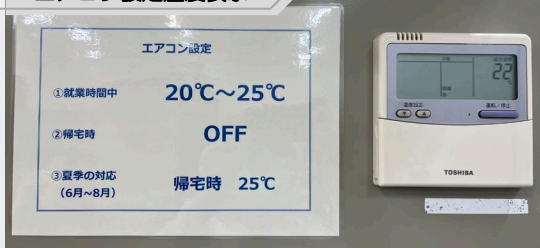
適正設定温度を掲示し、 実際の設定温度を記録しています。
