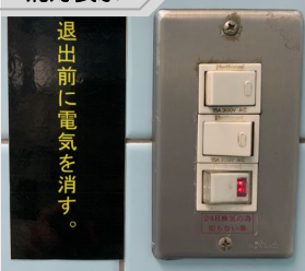
トイレ、更衣室、各事務所に 消灯表示を掲示。
